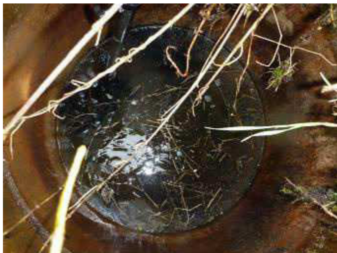
Figur 1.14: Brønd 3. Brønden havde et knækket dæksel.
