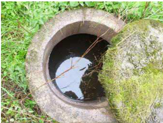
Figur 1.13: Brønd 2 placeret ved jordfaldshullerne
