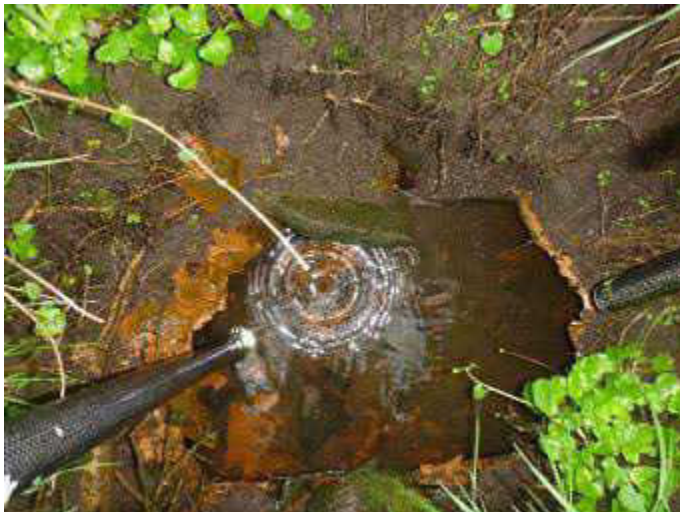
Figur 1.6: Ødelagt drænrør. Fra. St. 300 – 500 m var der adskillige jordfaldshuller.
