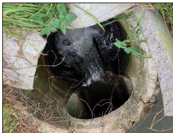
Foto 4. Set mod jordens centrum. 80 cm højt brøndstyrt ved start af 300 m rørledning. Ikke passabelt for fisk.
