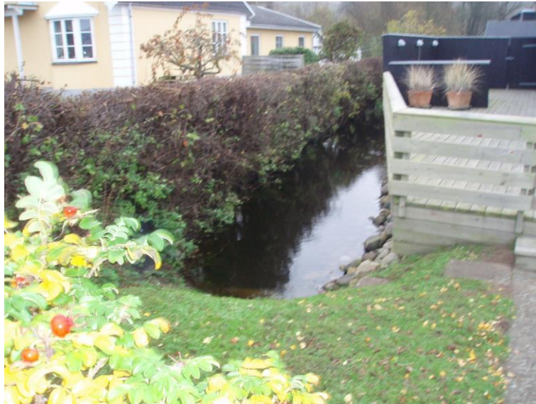
Figur 3-5 Afvanding af Kelstrup Strand vest sker fra denne grøft mellem husene til et rør under vejen
