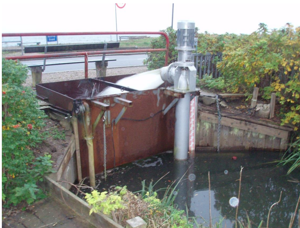
Figur 3-1 Højvandslukke og pumpe ved udløbet af Hejsager Bæk
