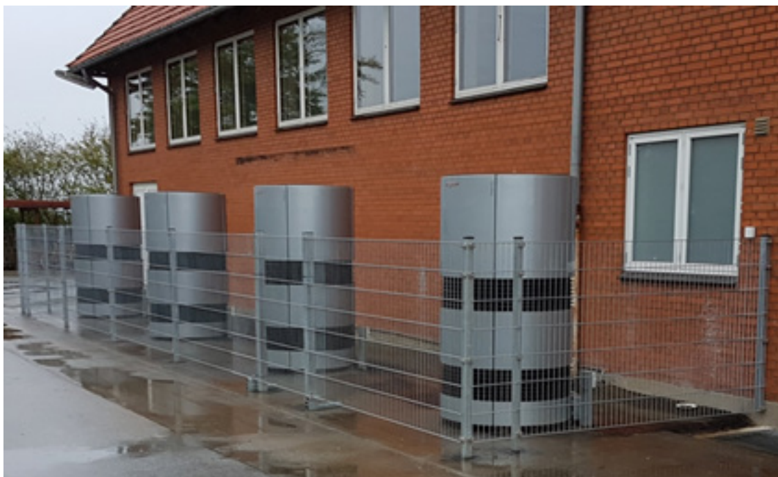
Varmepumpe udedele, Louiseskolen afd. Vonsbæk (skiftet fra oliefyr til varmepumper)
