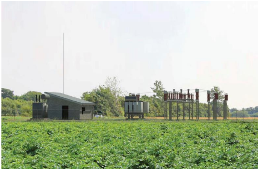
Figur 5.3: Eksempel på step-up transformer med tilhørende 20 meter høj lynafleder omkranset af trådhegn.
