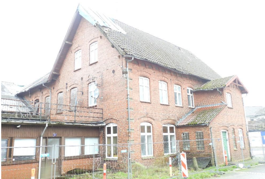
Figur 5.1 Billeder fra DMR A/S' besigtigelse d. 15. januar 2026 af bygningen på matr.nr. 101 Gram Ejerlav, Gram. I taget ses flere huller. Øv. Set fra nordvest, med Delbygning B forrest, Delbygning A tv. Og Delbygning C th. Ned. Delbygning A, set fra sydøst, med indgang til delbygning A gennem grøn dør til højre og indgang til delbygning B gennem dør til venstre.
