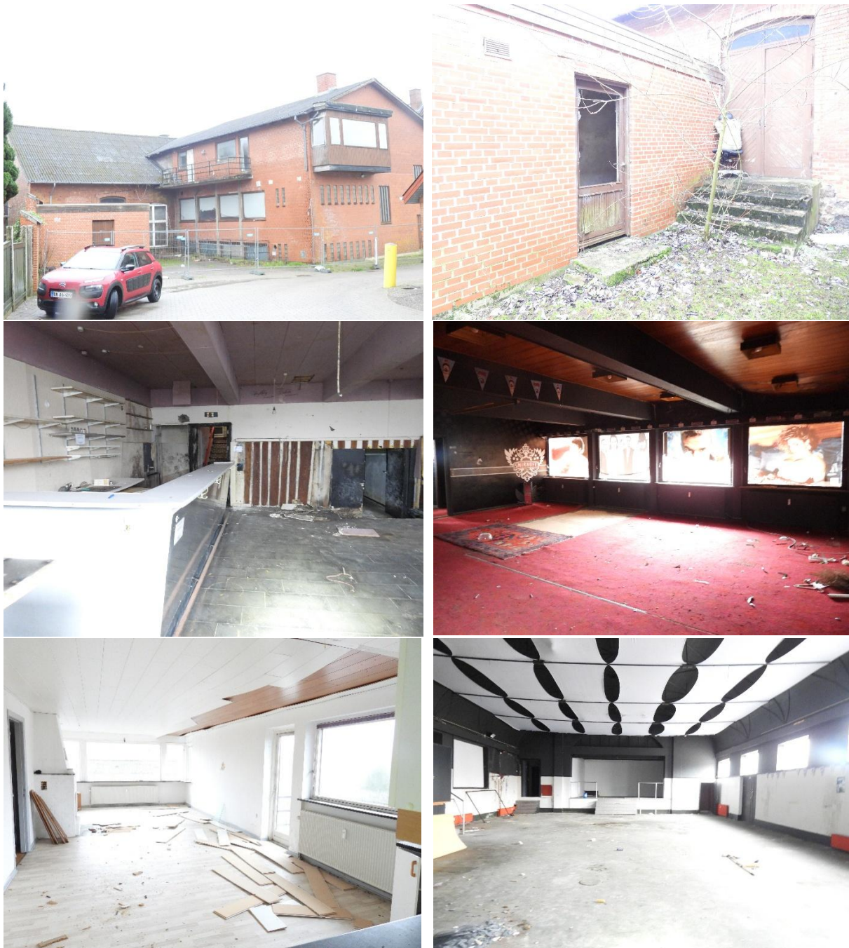
Figur 5.5 Billeder fra DMR A/S' besigtigelse d. 15. januar 2026 af bygningen på matr.nr. 101 Gram Ejerslav, Gram. Øv.tv. Delbygning C, set fra sydøst. Øv. th. Ødelagt dør i Delbygning C. M.th. Diskotekkælder i Delbygning C1. M.th. Diskotekdel i stueplan i Delbygning C1. Ned.th. 1. sal i Delbygning C1. Ned.th. Forsamlingssal i Delbygning C2-C3, hvor der over de viste hvide sejl er frit til undertaget.
