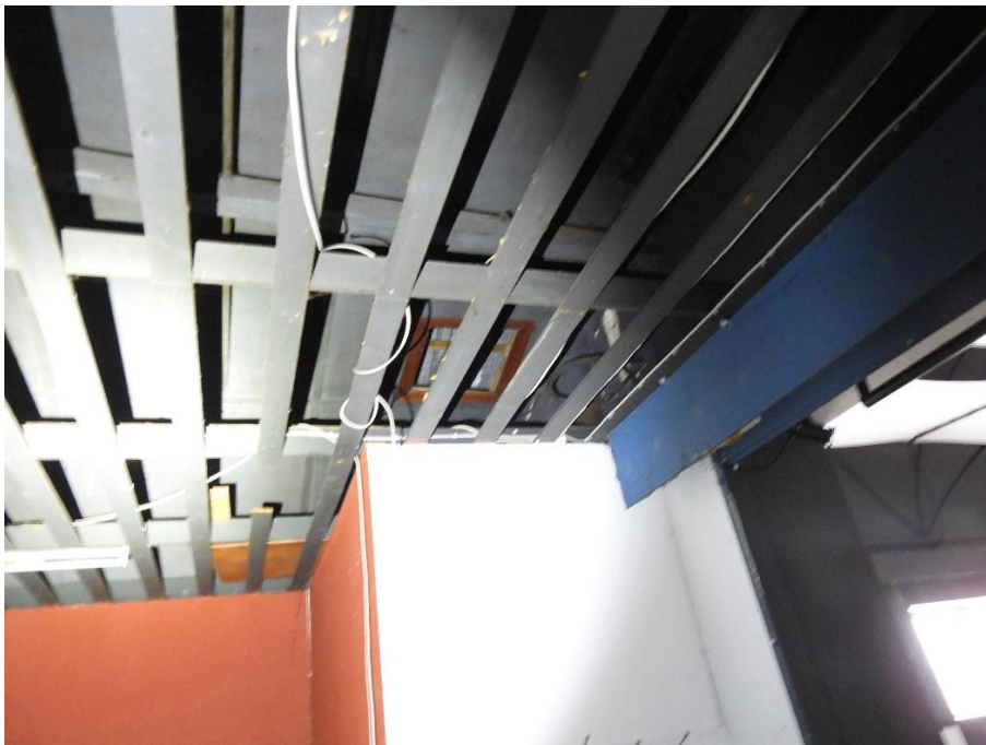
Figur 5.7 Billeder fra DMR A/S' besigtigelse d. d. 15. januar 2026 af bygningen på matr.nr. 101 Gram Ejerslav, Gram. Loftslem over scenen i C3-delbygningen.
