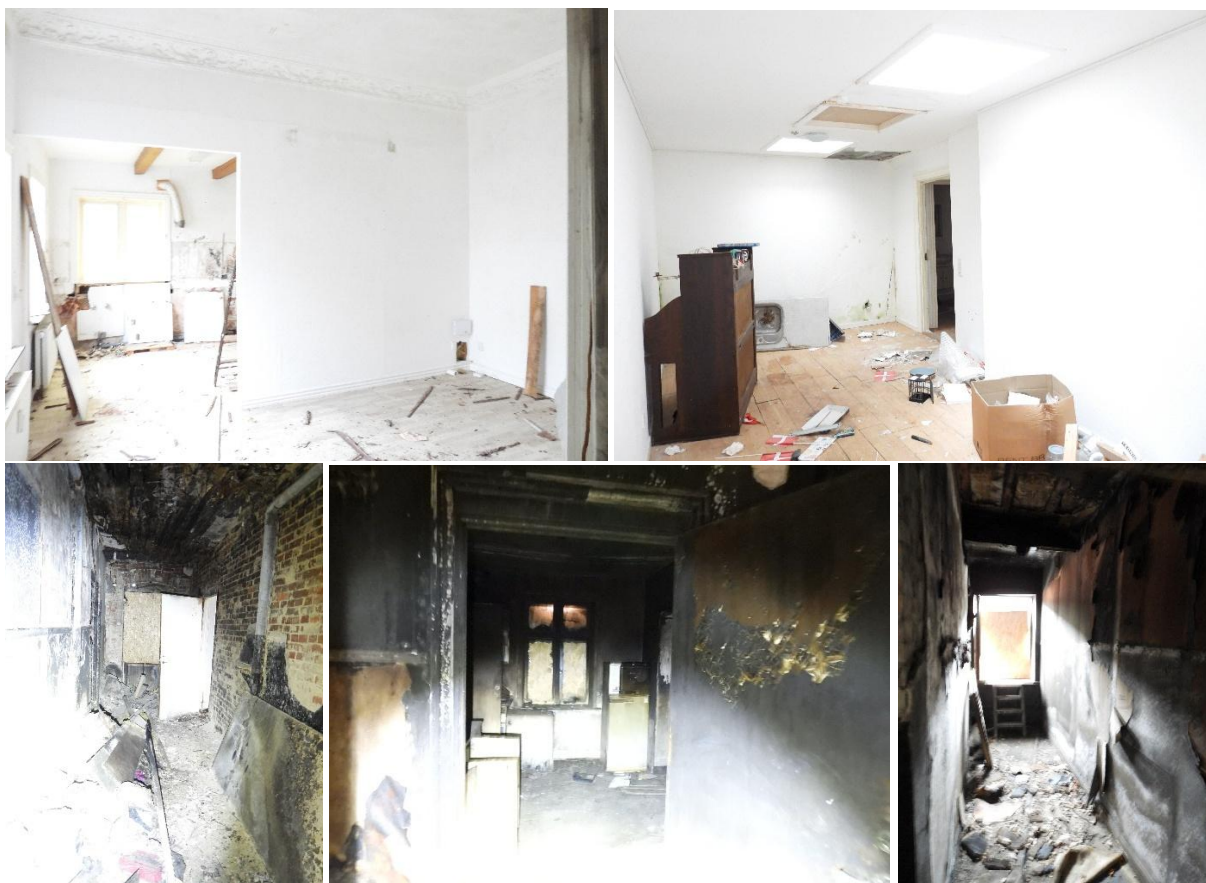
Figur 5.4 Billeder fra DMR A/S' besigtigelse d. d. 15. januar 2026 af bygningen på matr.nr. 101 Gram Ejerlav, Gram. Øv.tv. Indre rum i Delbygning A. Øv th. Indre del af Delbygning B. Ned. Brandpåvirkede rum på 1. etage i delbygning A.
