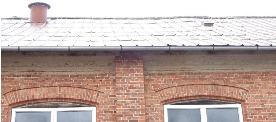
Figur 5.6 Billede fra DMR A/S' besigtigelse d. d. 15. januar 2026 af bygningen på matr.nr. 101 Gram Ejerslav, Gram. Ventilationstårn og hul i tagrygssten i Delbygning C, set fra vest.
