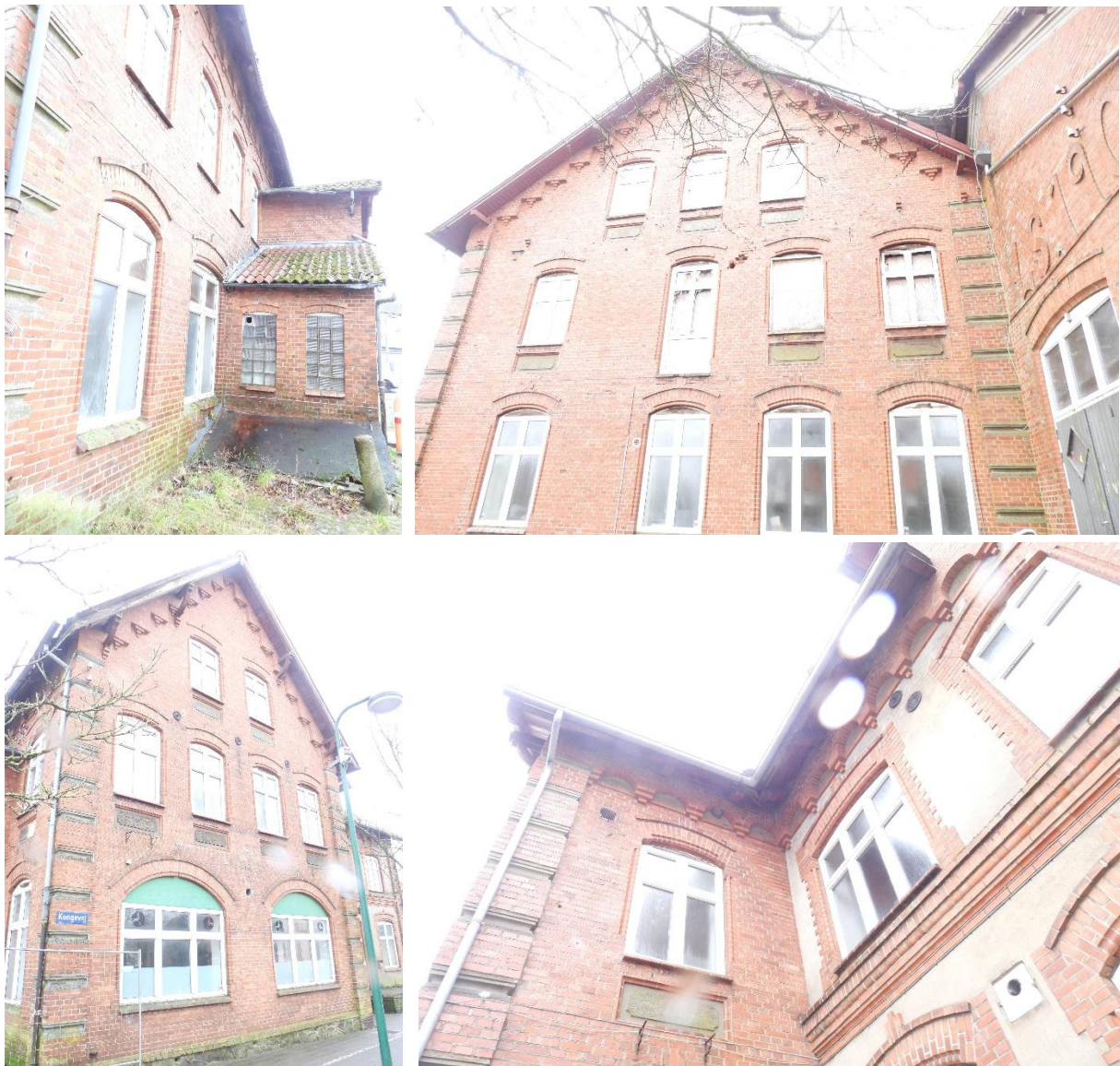
Figur 5.2 Billeder fra DMR A/S' besigtigelse d. 15. januar 2026 af bygningen på matr.nr. 101 Gram Ejerslav, Gram. Øv.tv. Knust rude i Delbygning A, set fra syd. Øv. th. Flere huller i facaden mod vest af Delbygning B. Ned.th. Ventilationshul i Delbygning A, set fra nord. Ned.th. Flere huller/ventilationshuller i facaderne på Delbygning A og B, set fra nordvest.
