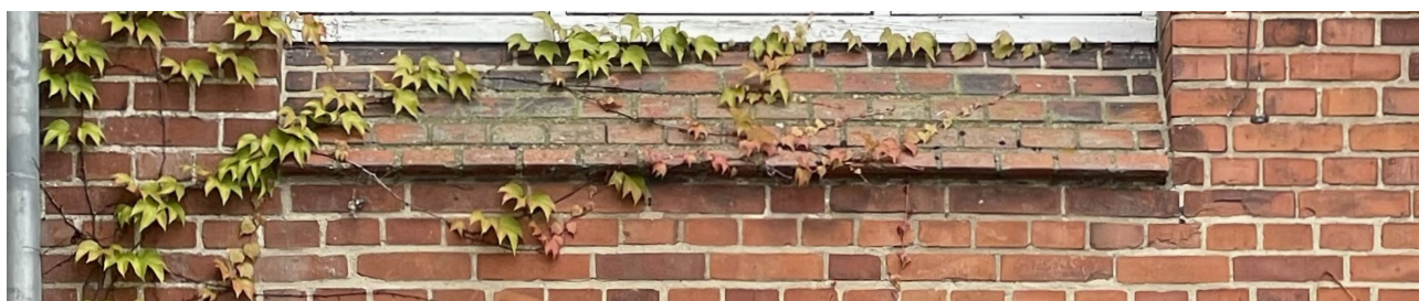
Bilag 5.7. - Muretdetalje - karakteristisk stejlt muret sålbænk i samme tegl som facaden
