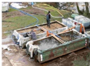
Sandfilter (2 20 fods åbne containere)
